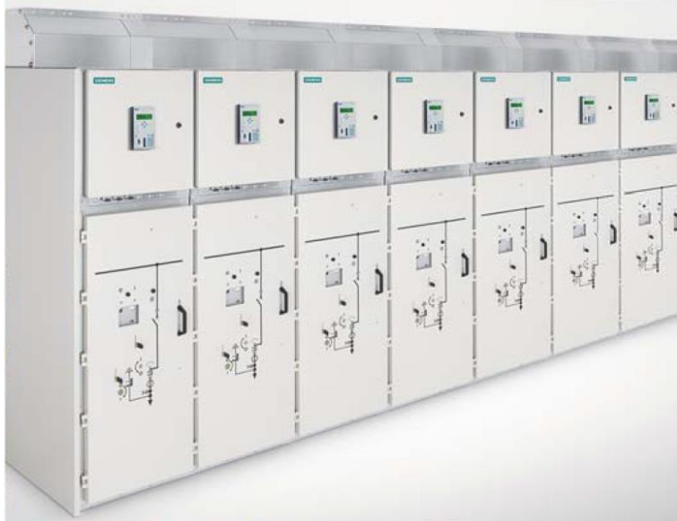
Фиг. 3.8 Външен изглед на комплектно разпределително устройство
